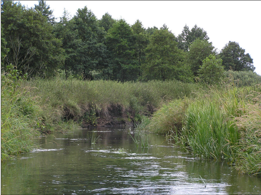
Ryc. 16. Punkt X13 oceny hydromorfologicznej – erozja lewego brzegu na drugim zakolu meandru rzeki (fot. A. Skrzypczak).
