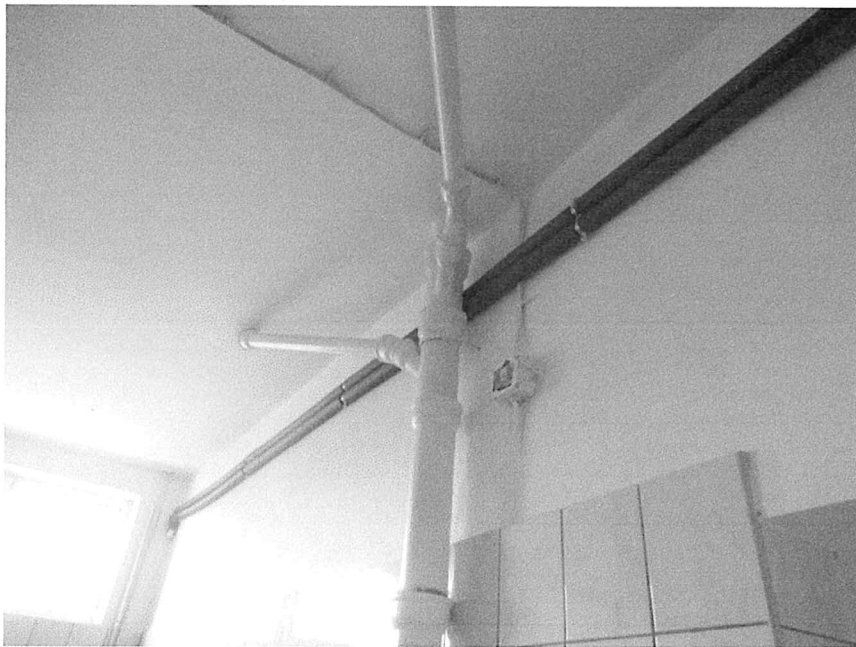
Fot. nr 2. Sanitariat dla chłopców w parterze budynku szkolnego (widoczny pion kanalizacyjny – do wymiany)
