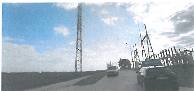
Wyjście linii napowietrznych 110 kV GPZ Nidzica i GPZ Działdowo
