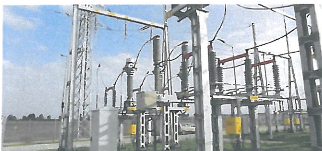
R-110 kV. Pole rozdzielcze linii 110 kV GPZ Nidzica
