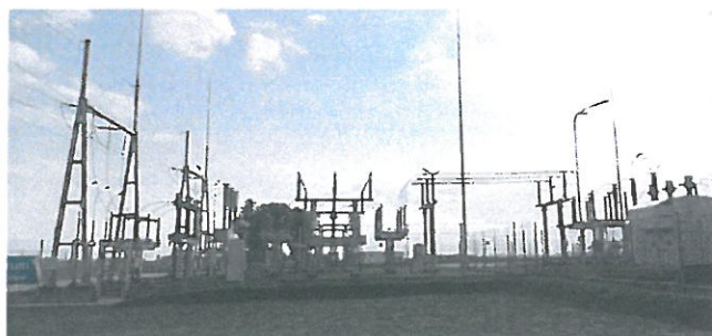
Stacja elektroenergetyczna RS Zakrzewo – widok ogólny
