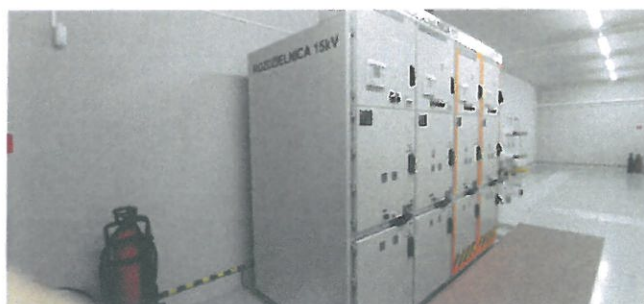
R-15 kV w budynku stacyjnym
