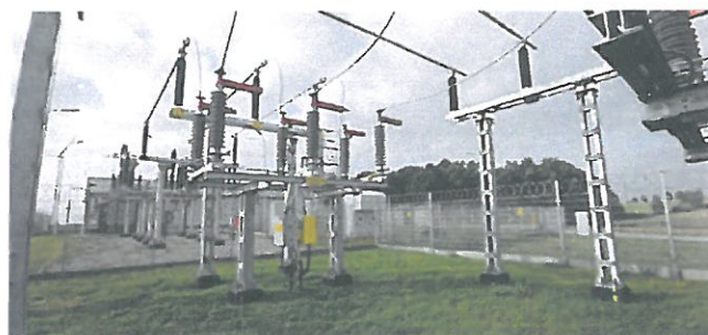
R-110 kV. Pole rozdzielcze GPO Kozłowo
