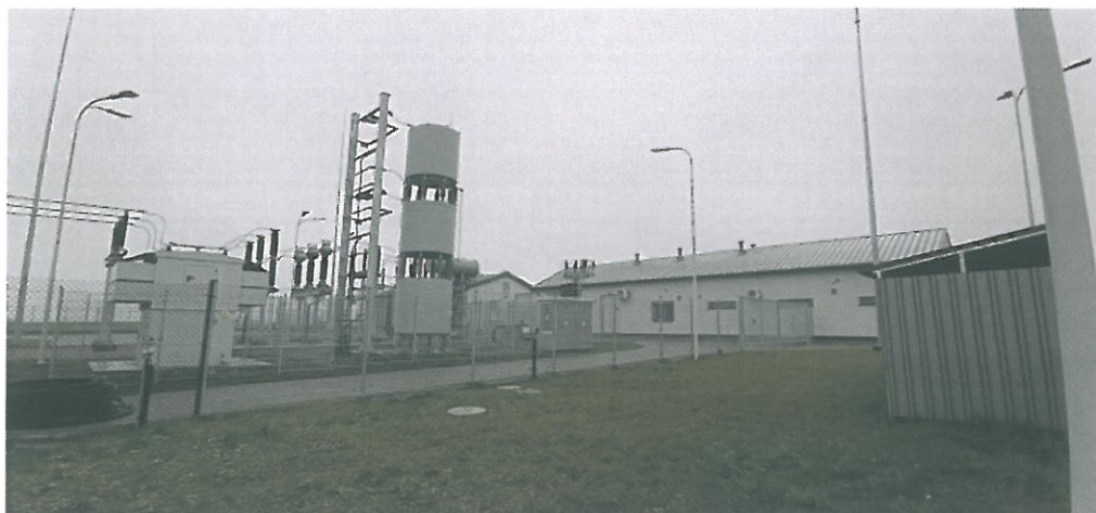
Widok ogólny na stację GPO Kozłowo od strony baterii kondensatorów
