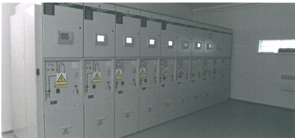
Rozdzielnia wewnątrzowa 30 kV
